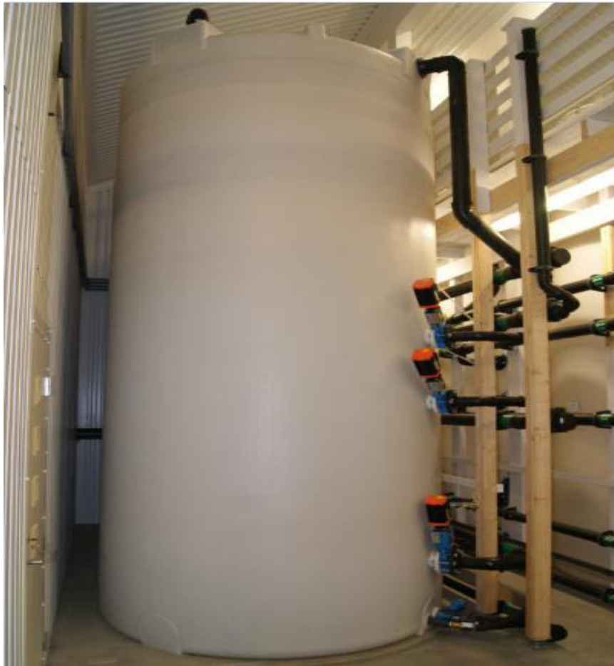
Bildet viser 1stk SBR-reaktor med pneumatisk styrte ventiler.
