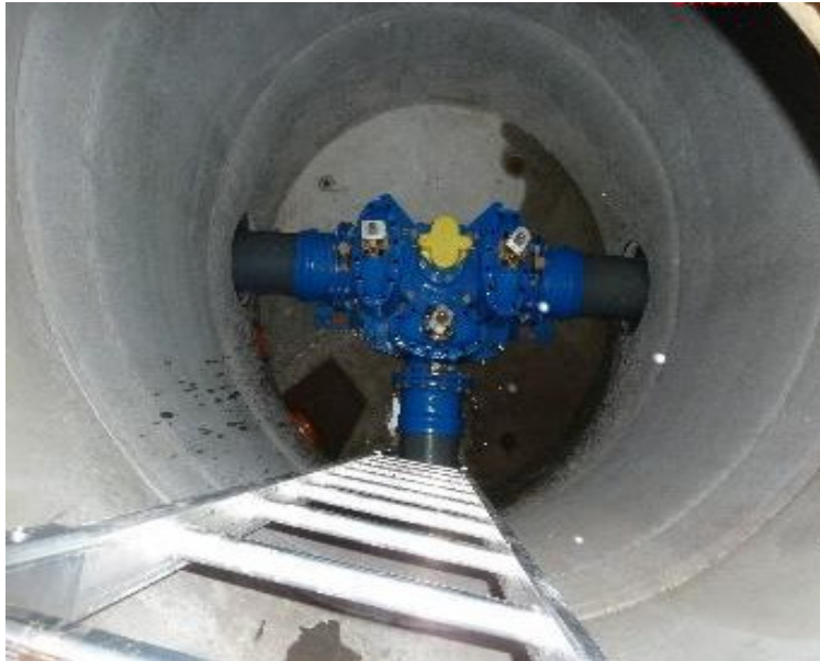
Eksempel på vannkum med sluseventiler og brannventil.
